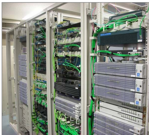
情報センター 送受信設備
